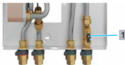
Fig. 28: Positon de l'élément filtrant sur le retour du circuit de chauffage
