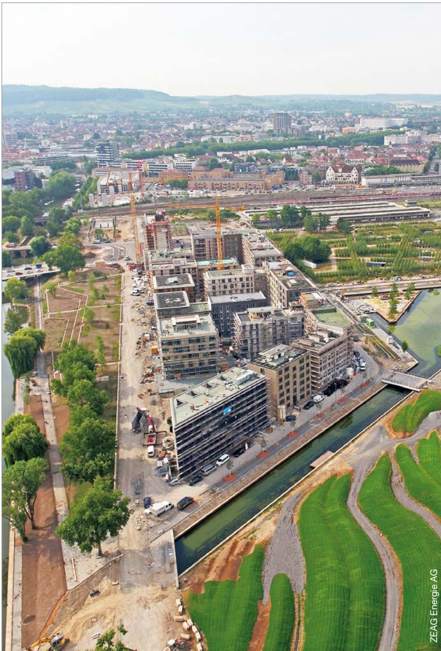
Das Stadtquartier Neckarbogen während der Bauphase. In der Umgebung entstehen die Grünflächen der BUGA 2019.
